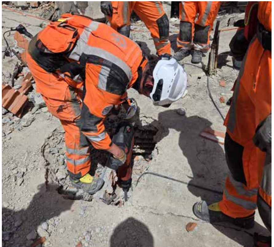
Verschüttete Räume müssen geöffnet werden, um Überlebende zu finden.
