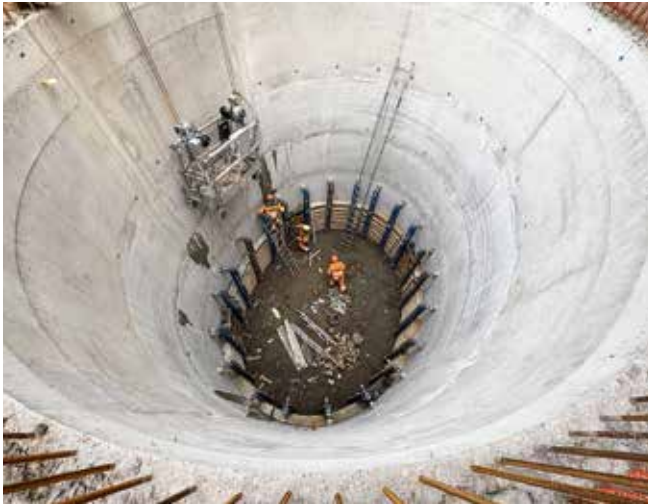
Aushub und Betonage der teilweise über 20 Meter tiefen Schächte für die Pfeiler der neuen Buochholzbrücke. (Foto: Emch+Berger WSB AG, Januar 2026)
