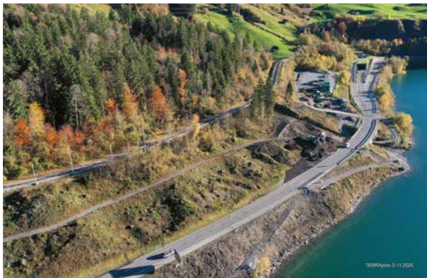
In anspruchsvoller Topographie, zwischen der Brünigstrasse und dem Trassee der Zentralbahn, entsteht der neue Nationalstrassenabschnitt der N8. (Foto: TERRAplan, November 2025)
